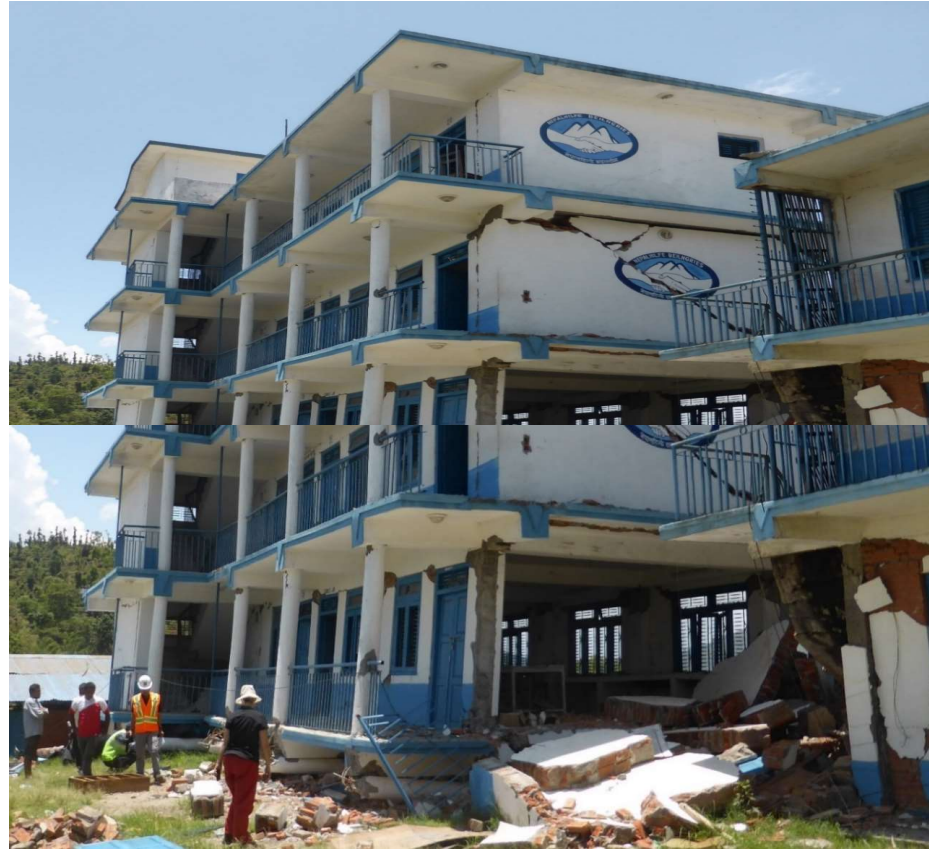
Пример обрушившегося школьного здания в Непале при землетрясении 2015 года [обрушение слабого этажа]
