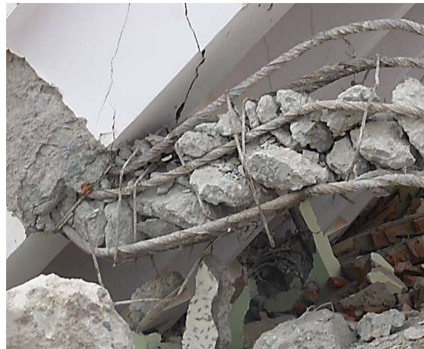
Обрушение ЖБ каркасного здания с недостаточным поперечным армированием колонн (землетрясение в Непале в 2015 г.)
