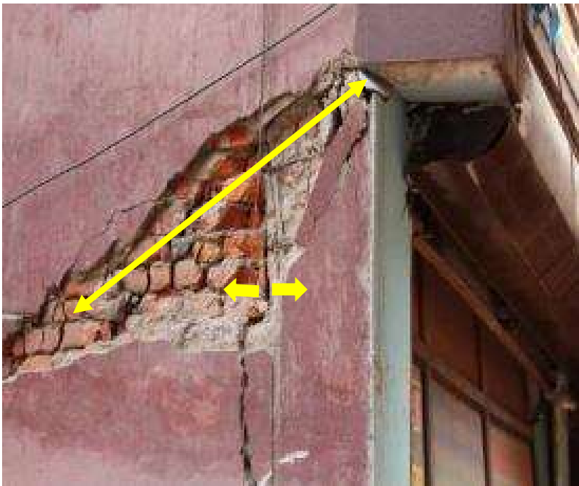
Разрушение ЖБ колонны каркасного здания из-за среза в результате землетрясения в Горкхе, Непал, в 2015 году.
